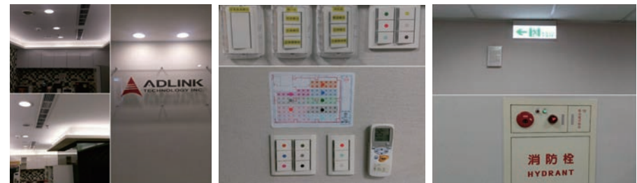
辦公室照明由更換為 LED 及 T5 省電型燈具 消防栓指示燈具更換為省能 LED 燈具 辦公室增設空調及照明總開關及對應控制圖
